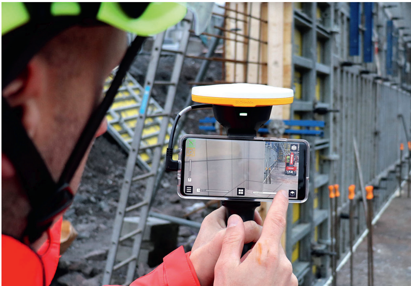
3D-scanning er en innovativ løsning som gir arbeidere mulighet til å sjekke konstruksjonen opp mot tegninger i sanntid.
